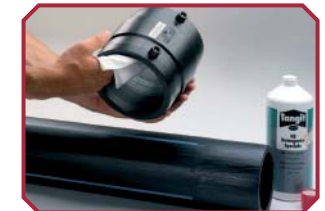
Mecanizar a superfície da zona de soldadura com um torno ou com uma ferramenta adequada.
